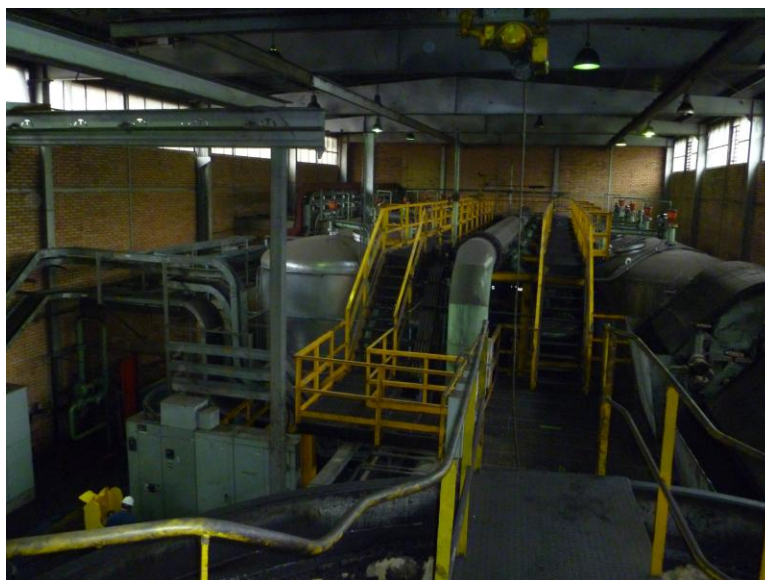
Figura 4. Sala de filtros PTA
