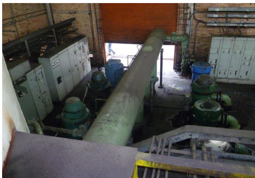
Figura 5. Sala de bombas, PTA
