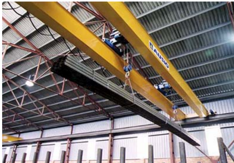
Figura 3. Puente grúa de viga doble
