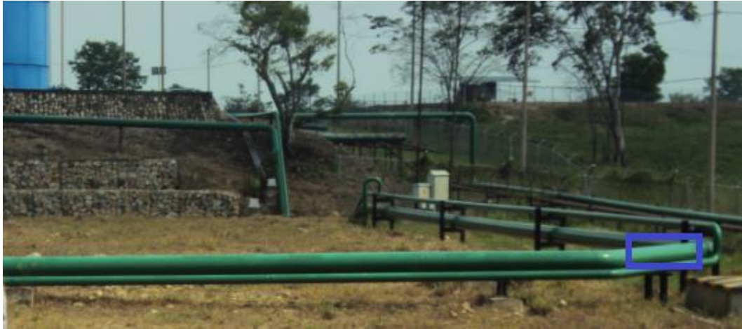
Foto 7. Tubería de salida tanque de almacenamiento. Fuente: Los autores.
