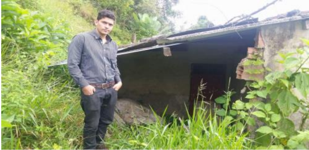
Fotografía 39. Casa semidestruida por derrumbe roca.
