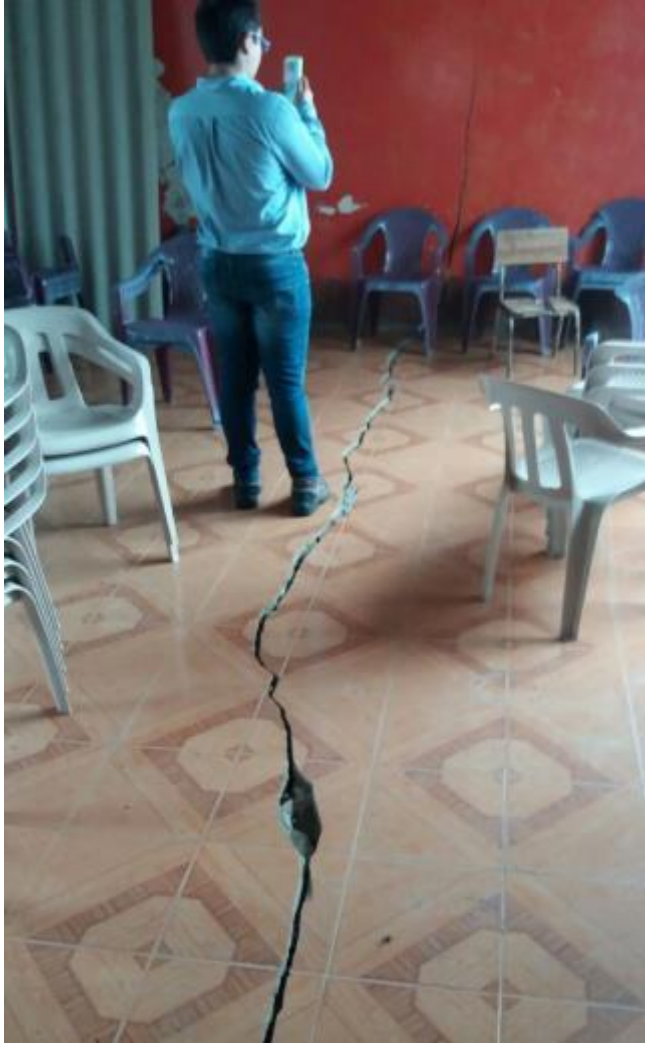
Fotografía 34. Grietas en piso de salón de clases
