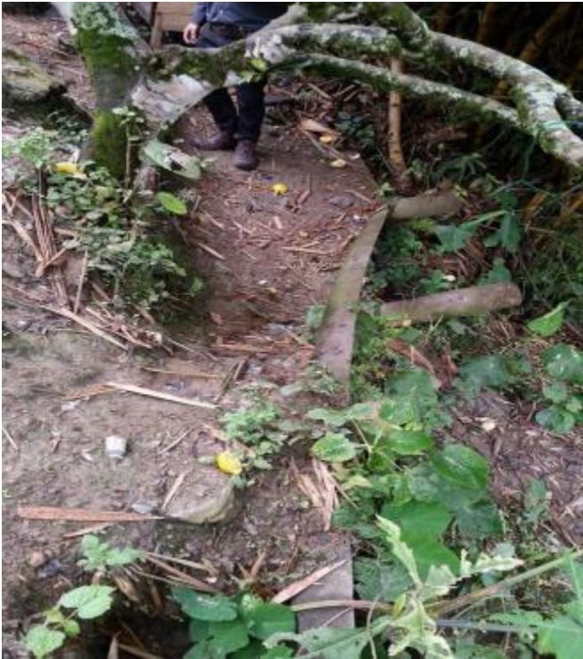
Fotografía 46. Gaviones desnivelados detrás de la vivienda.
