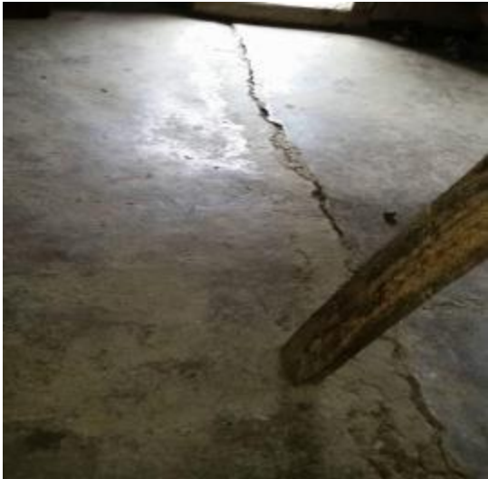
Fotografía 45. Vivienda con posibilidad de derrumbe
