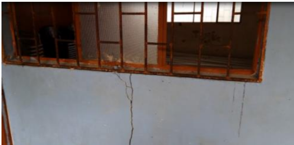
Fotografía 33. Grietas en salón de clases.
