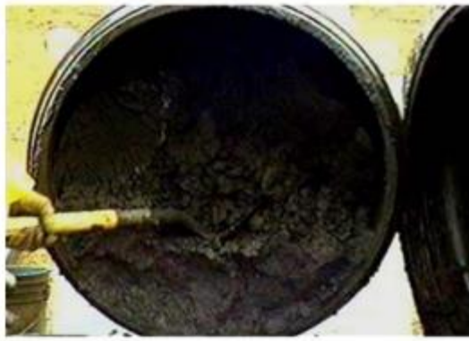
Figura 10. Polvo negro en gasoducto
