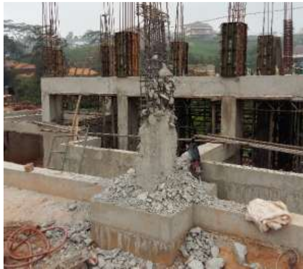
Figura 20. Columnas demolidas por baja resistencia de concreto.
