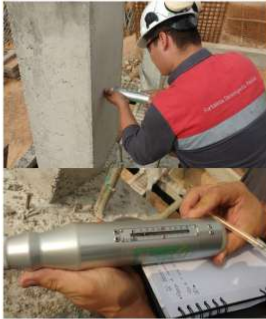
Figura 19. Esclerometría realizada a columnas mencionada anteriormente.
