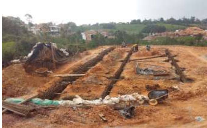
Figura 12. Armado de zapatas, vidas de amarre y zapata corrida para muro de contención.
