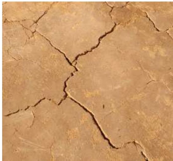
Figura 6. Grietas encontradas en zona de relleno compactado.
