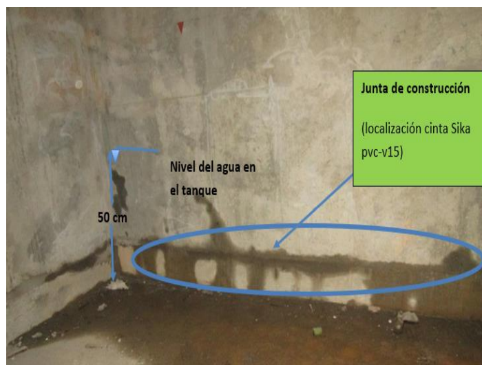
Figura 10. Filtración en la junta de construcción del tanque.
