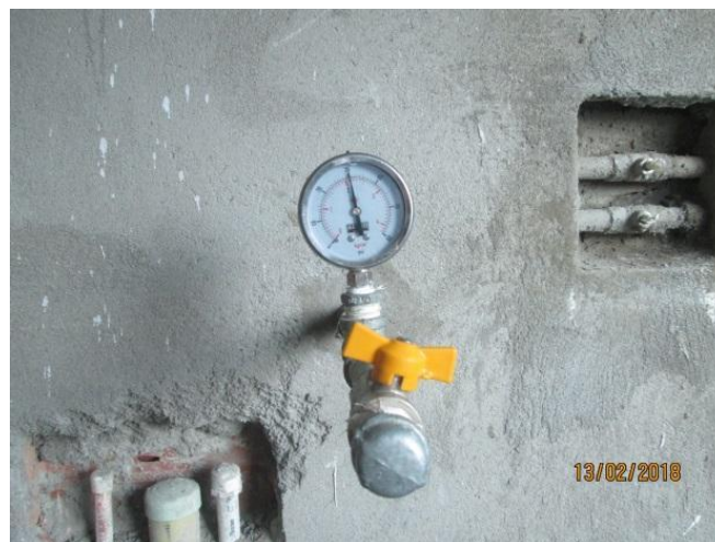
Figura 16 .Manómetro Winters de 60 psi para medir presión en tubería de Gas.
