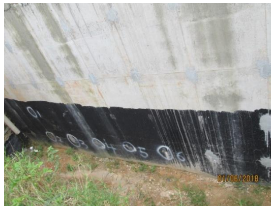
Figura 14. Puntos de filtración en el tanque de almacenamiento.
