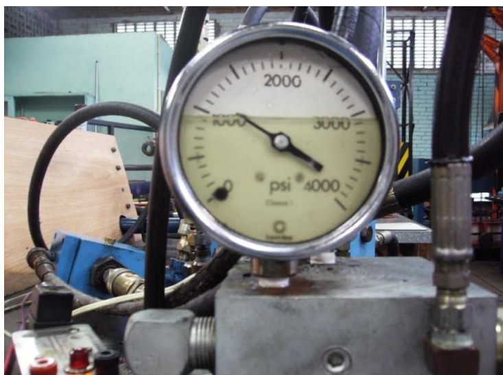
Figura 75. Presión De La Válvula De Seguridad En La Etapa De Trabajo
