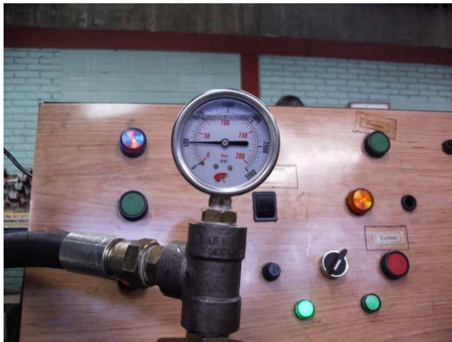
Figura 79. Presión De La Válvula De Descarga En La Etapa De Regeneración
