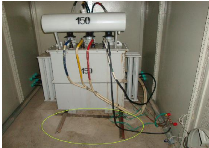
FIGURA 30: PISO DEL TRANSFORMADOR 2 FUENTE AUTORAS
