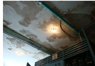
FIGURA 22: SÓTANO TABLEROS GENERALES FUENTE AUTORAS
