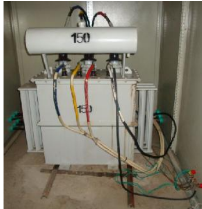
FIGURA 5: TRANSFORMADOR TRIFÁSICO 150KVA 13,2KV/440-254V, FUENTE LAS AUTORAS
