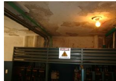
FIGURA 23: SÓTANO TABLEROS GENERALES FUENTE AUTORAS
