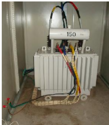
FIGURA 6: TRANSFORMADOR TRIFÁSICO 150KVA 13,2KV/220-127V, FUENTE LAS AUTORAS
