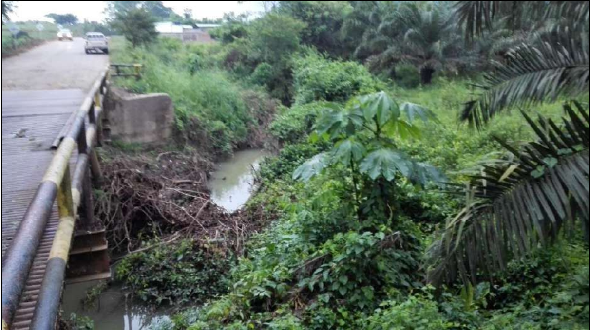
Fotografía 6.1 Basura acumulada en la pila intermedia del puente en el caño 2
