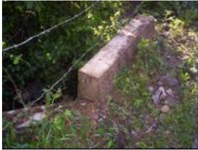
ESTRUCTURA DE ENTRADA
