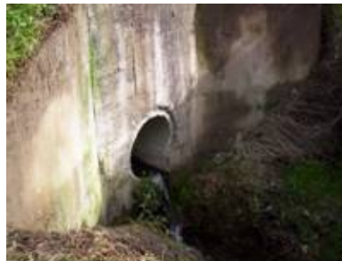
ESTRUCTURA DE SALIDA
