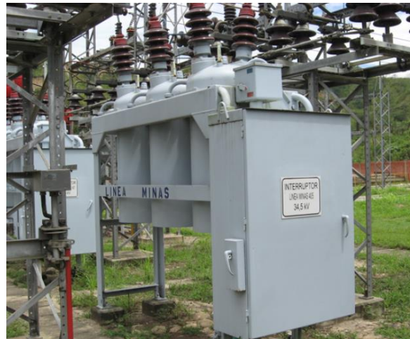
Equipos de la Bahía de la Línea 405 Minas-Palenque
