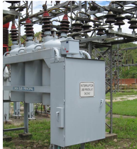
Equipos de la Bahía de la Línea 407 Principal-Palenque
