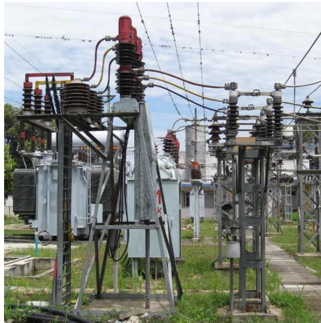
Equipos de la Bahía de transformación asociada al lado de baja del Transformador T-6
