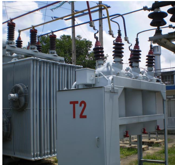
Equipos de la Bahía de transformación asociada al lado de alta del Transformador T-2
