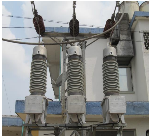
Equipos del Barraje de 34,5kV
