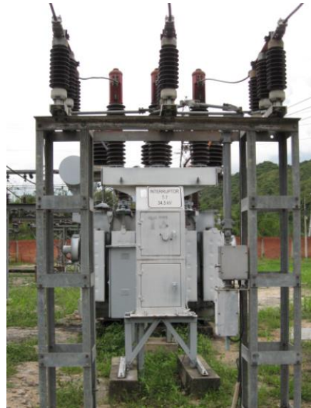
Equipos de la Bahía de transformación asociada al lado de alta del Transformador T-7
