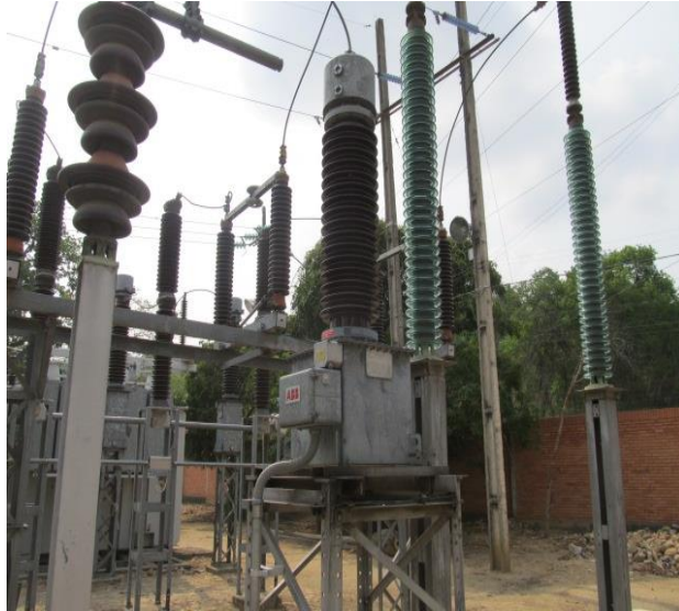
Equipos del Barraje de 115kV
