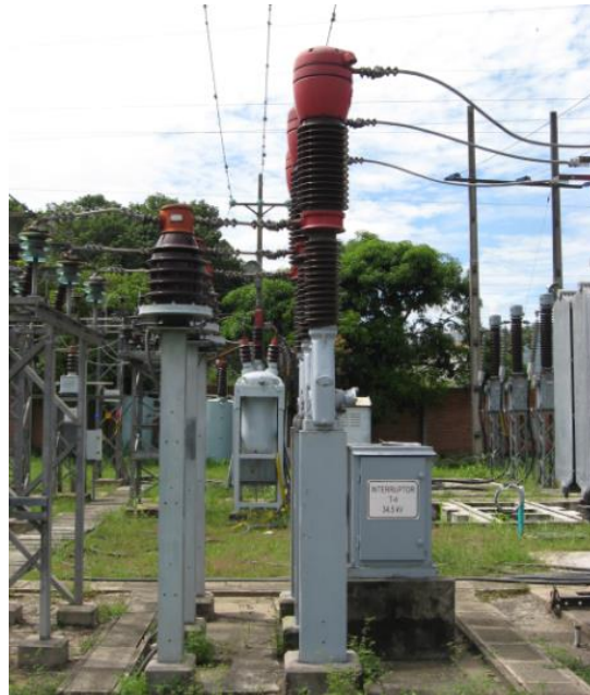
Equipos de la Bahía de transformación asociada al lado de baja del Transformador T-4
