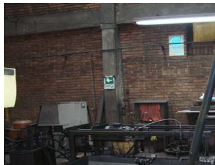
Figura 20. Condición actual de las paredes en Industrias Lavco
