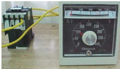
Figura 76. Contactor y pirómetro
