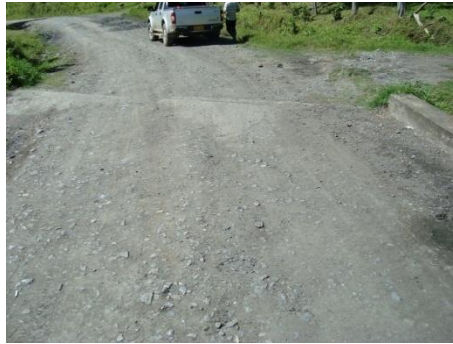
Ilustración 18. Registro del bordillo izquierdo.
