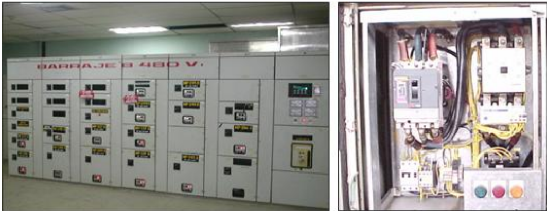
Figura 13. Fotografía de un CCM (izq.) y de una casilla de baja tensión (der.)
