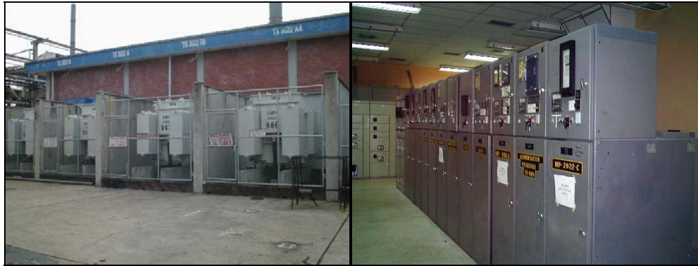
Figura 11. Fotografías del exterior (izq.) y del interior (der.) de una S/E
