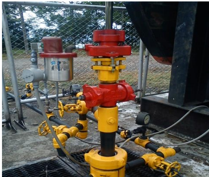
Figura 20. Cabeza de pozo con BOP y APA instalado
