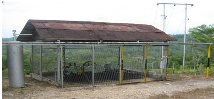
Figura 18. Cuarto de Bombas San Luis
