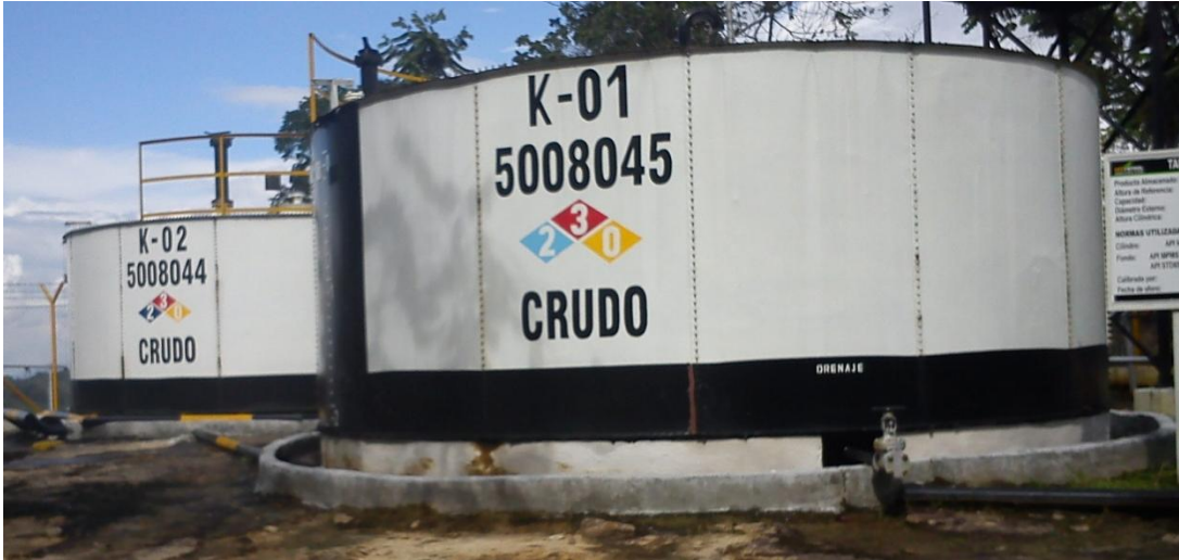
Figura 17. Tanques existentes del campo San Luis
