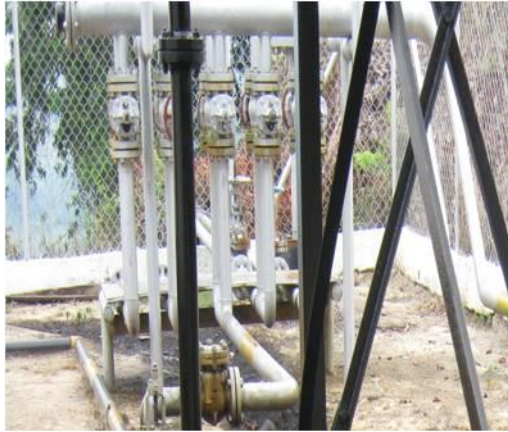
Figura 16. Manifold existente estación San Luis
