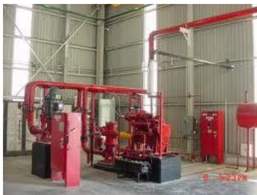
Figura 14. Sistema de contraincendios
