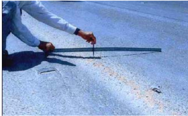
Figura 2. Deformación permanente en pavimentos
