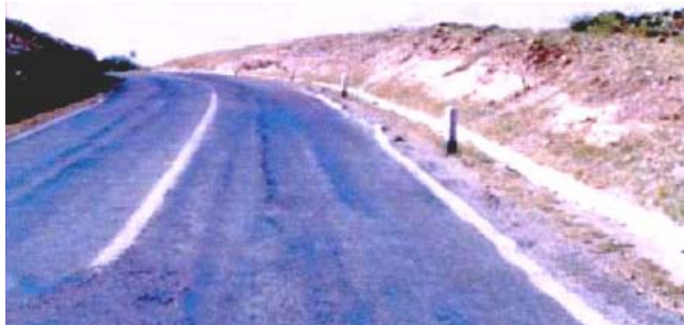
Figura 1. Deformaciones plásticas en la vía
