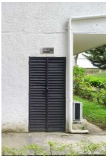
Figura 22. Cuarto de almacenamiento de para residuos peligrosos Bienestar Universitario (Sección Salud)
