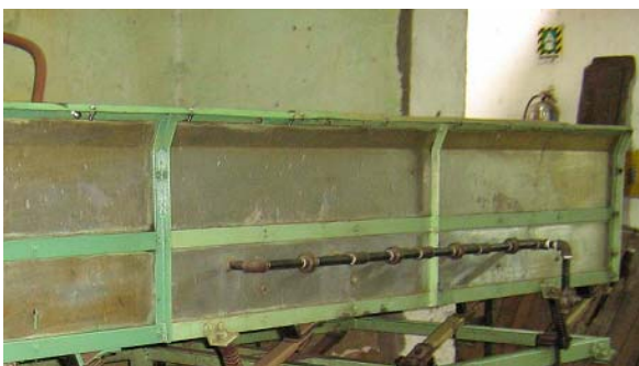
Figura 50. Aspecto final del sistema de vapor
