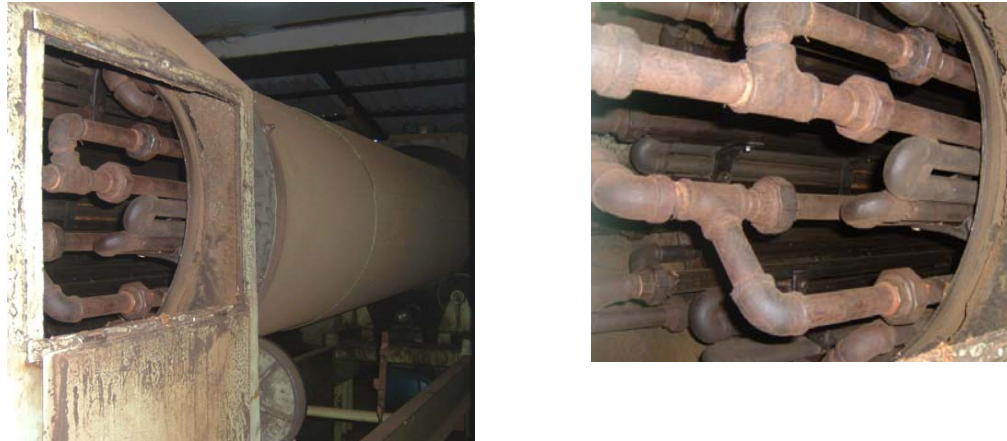
Figura 110. Tubería de vapor del cilindro secador.
