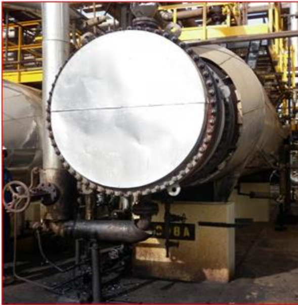
Foto 1. Intercambiador de calor E2808 – Refinería Barrancabermeja – Ecopetrol S.A
