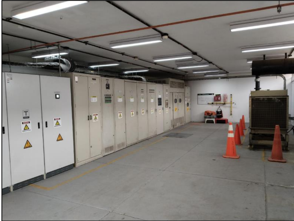
Nota: Subestación eléctrica a modificar Autor 2024
