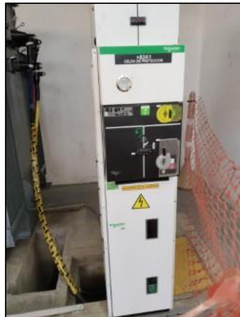
Autor 2025 Nuevo seccionador en SF6
