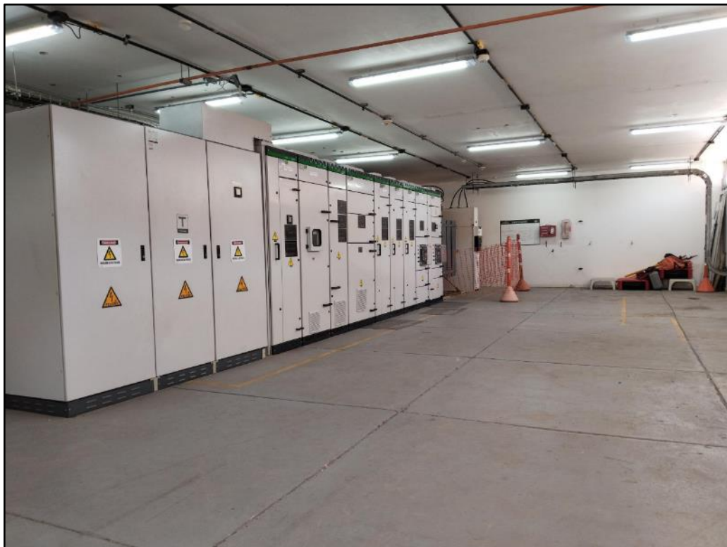
Nota: Subestación eléctrica modificada Autor 2025
