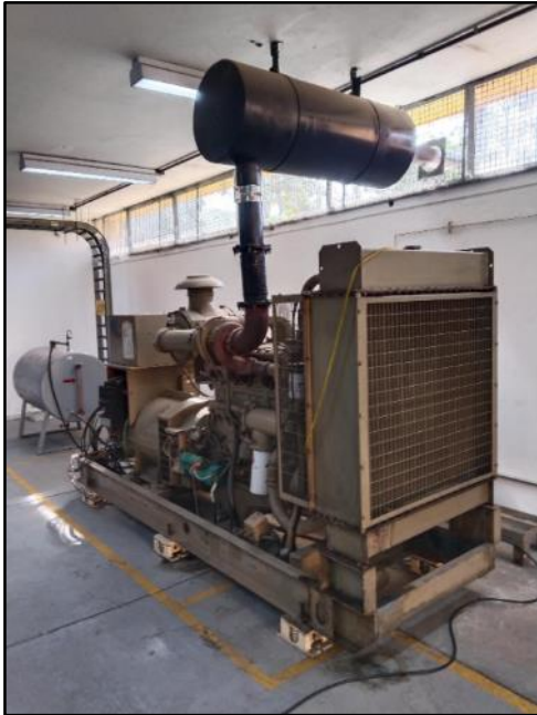
Autor 2024 En la Subestación eléctrica
