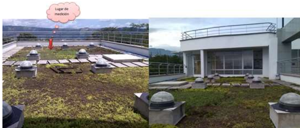
Figura 8. Techo verde Edificio de Ingeniería Eléctrica UIS
