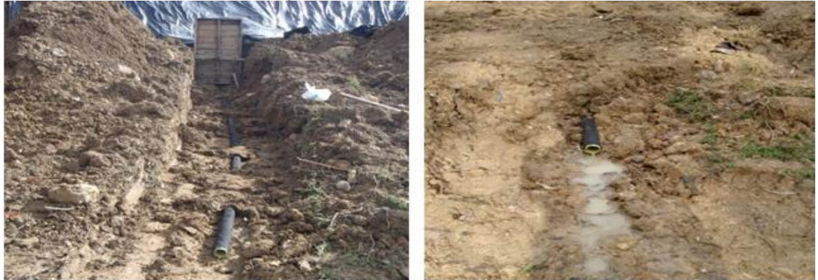
Ilustración 24: Colectores del drenaje.
