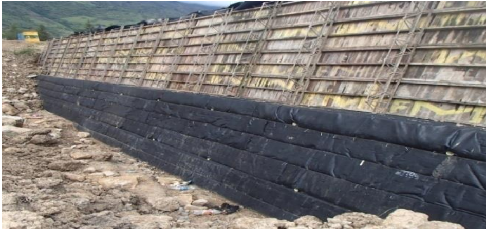
Ilustración 28: Lloraderos en la fachada del muro.
