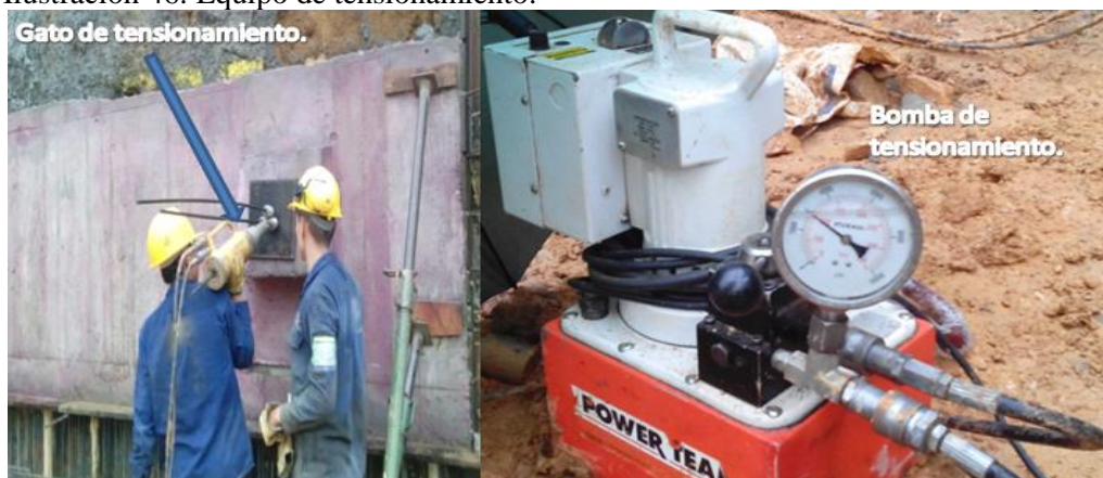
Ilustración 46: Equipo de tensionamiento.
