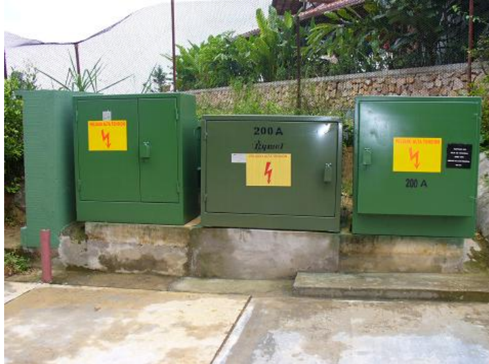
Figura 1.4 Subestación tipo jardín (pad mounted)
