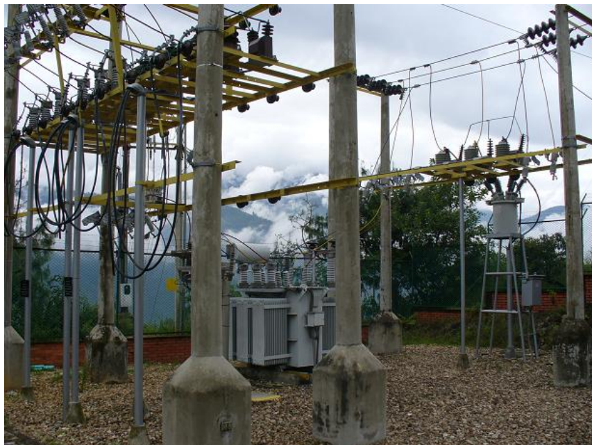
Figura 1.2 Subestación de pedestal
