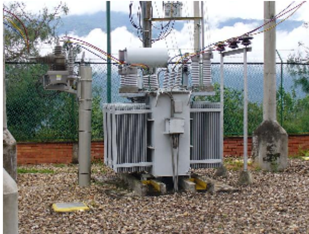
Figura 1.5 Transformador de distribución
