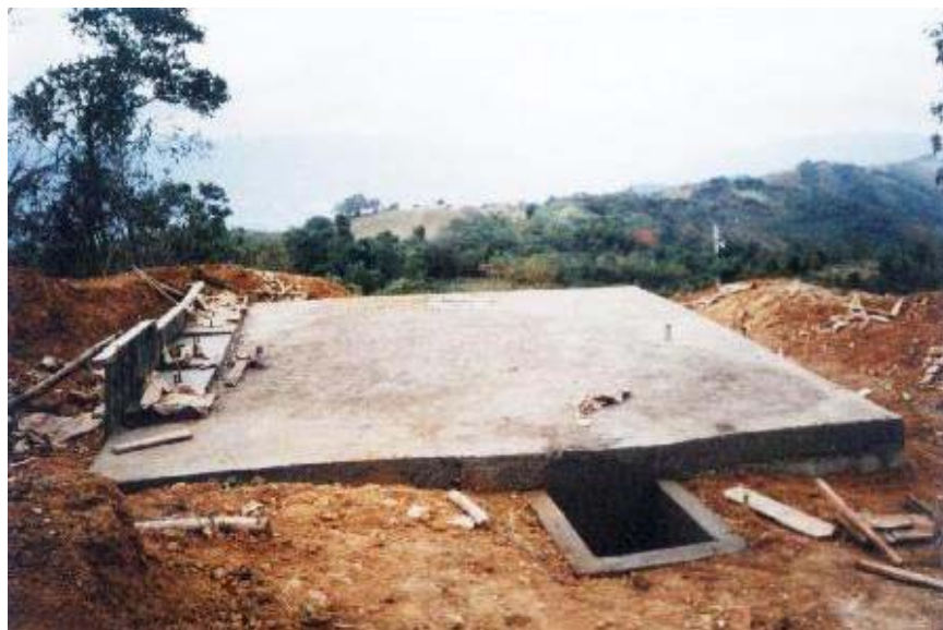
IMAGEN 7. Tanque de almacenamiento
