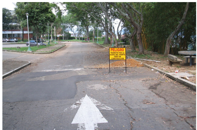
Foto 2. Malla Vial Perimetral UIS, deterioro de Pavimento debido principalmente a la acción del tránsito y a las condiciones climáticas entre otros.(2005)
