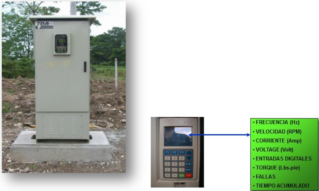
Figura 5. Variadores de frecuencia marca UNICO.
