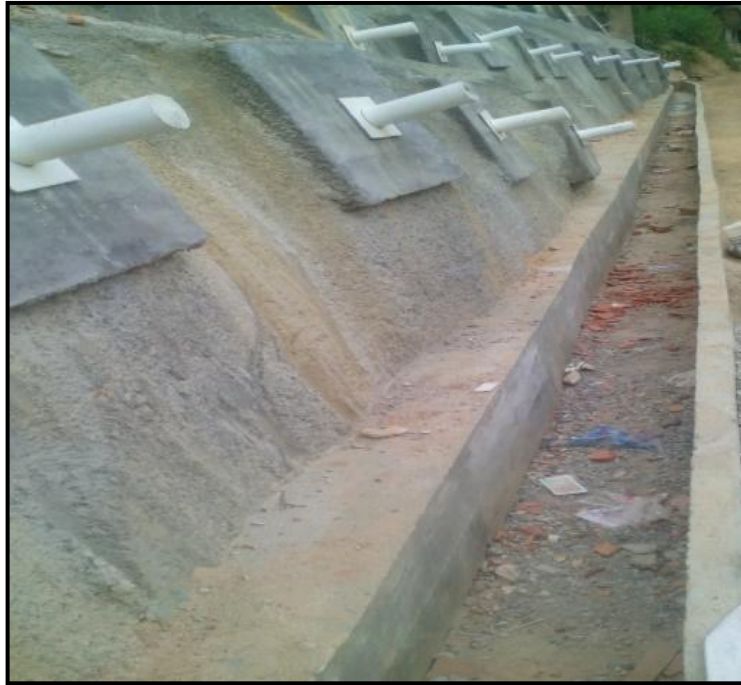
Figura 11. Vista de la canaleta para la conducción de aguas lluvias realizada en el pie de la estructura de contención-Barrio Granjas de Provenza del Municipio de Bucaramanga-Contrato No. 9235-01.
