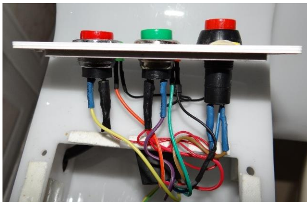
Figura 110. Conexiones de los elementos de control (pulsadores).
