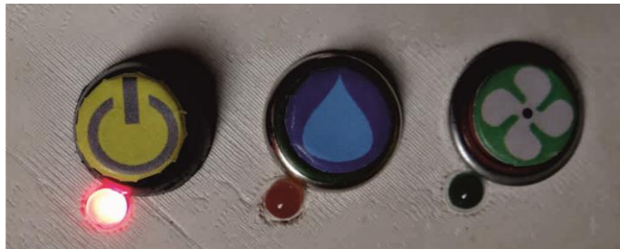
Figura 68. Comprobación técnica del sistema electrónico encendido.
