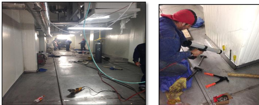
Ilustración 27. Aislamiento túnel de enfriamiento
