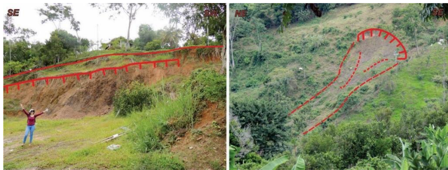
Figura 17. Deslizamiento traslacional cerca de la cabecera municipal y flujo de detritos ubicado en la vereda Mérida.
