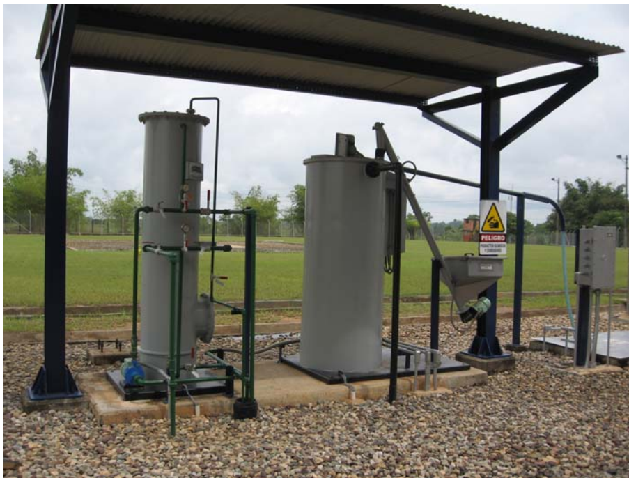
Figura 13. Sistema de tratamiento de aguas de desecho
