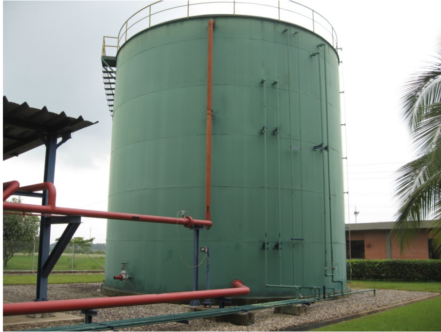
Figura 11. Tanque de almacenamiento de Agua
