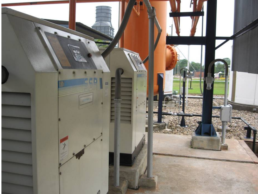
Figura 7. Sistema de aire comprimido
