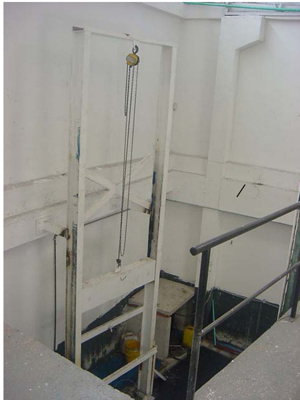
Figura 42. Riesgo de caída en el segundo nivel.
