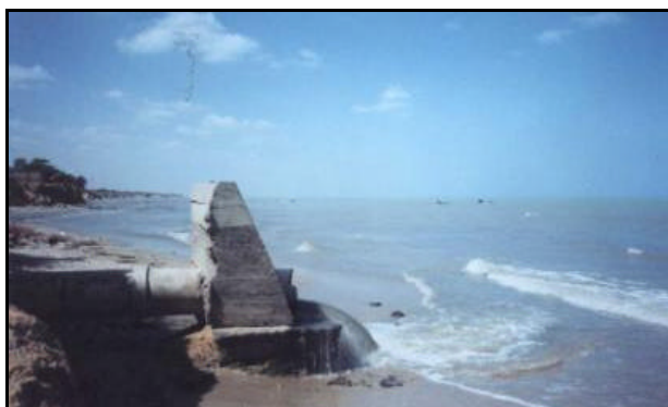
Figura 64. Emisario final del sistema de alcantarillado del municipio de Riohacha
