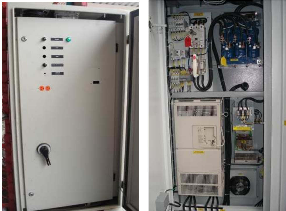
Figura 17. Variador de frecuencia con filtro, resistencia y banco de condensadores.
