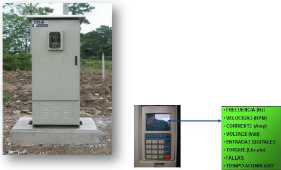
Figura 6. Variador de frecuencia marca UNICO
