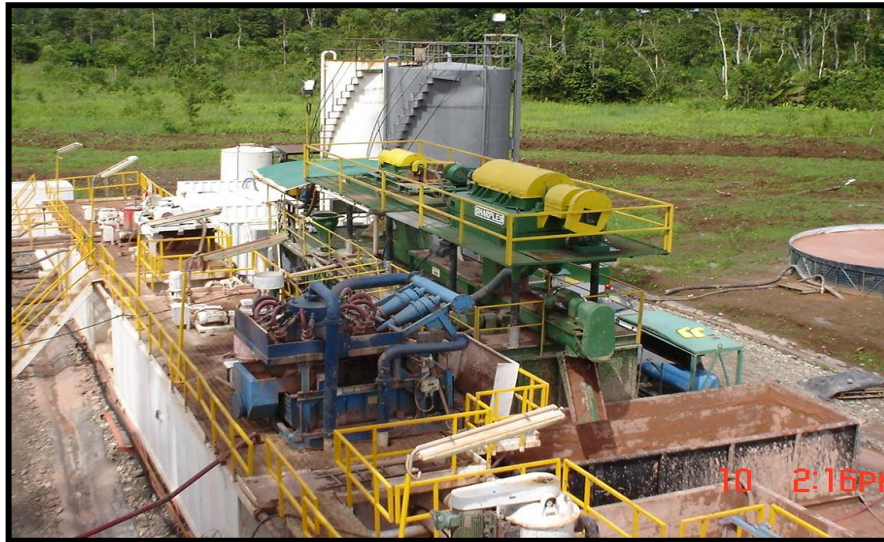
Figura 2. Equipo de control de sólidos
