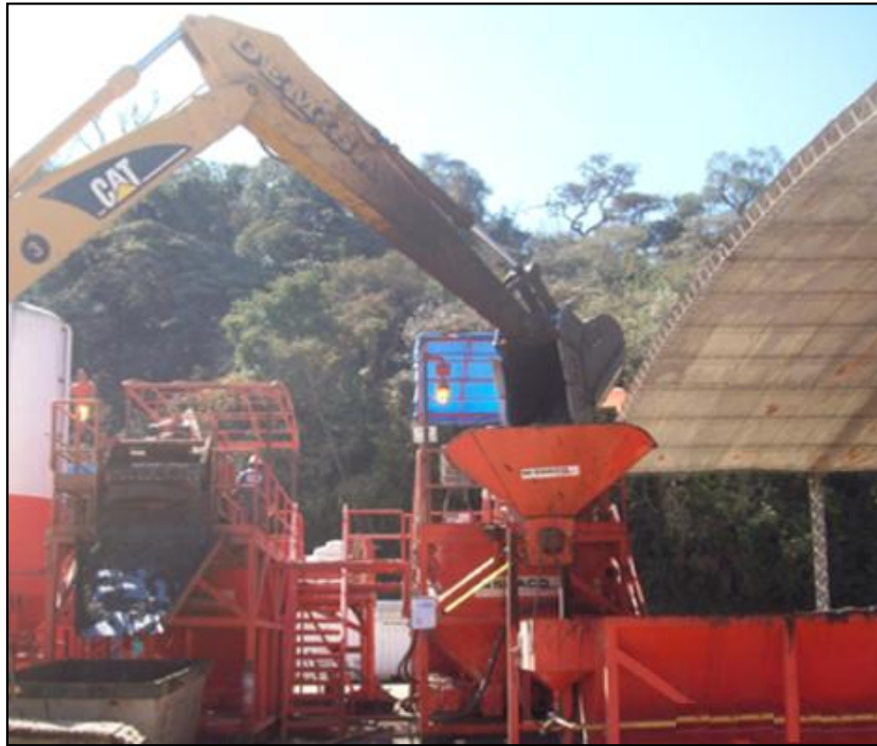
Figura 73. Unidad de tratamiento
