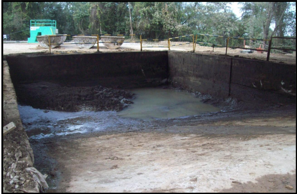
Figura 70. Pileta de cemento
