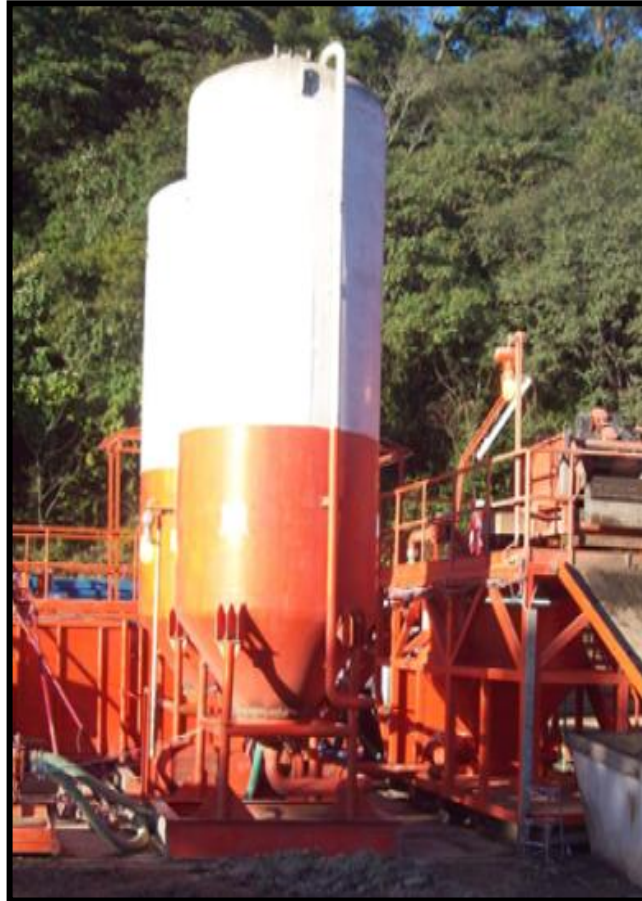
Figura 74. Tanque de almacenamiento de la lechada
