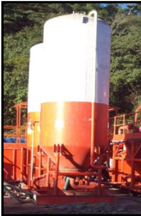
Figura 20. Tanques de almacenamiento
