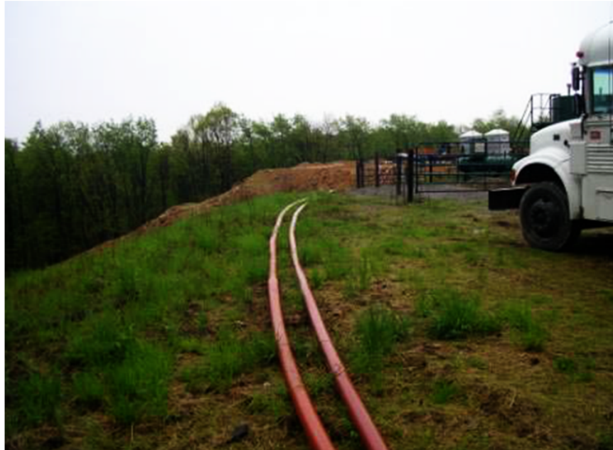
Imagen 15. Tubería utilizada en el bombeo
