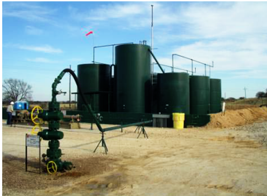
Imagen 16. Pozo de disposición de aguas residuales y tanques de almacenamiento en Texas
