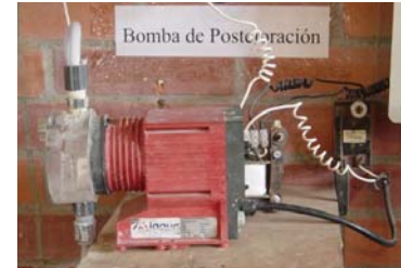
Imagen 14. Bomba de Postcloración
