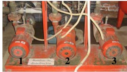
Imagen 10. Bombas de distribución
