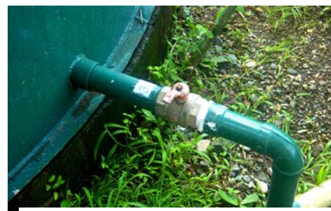
Imagen 1. Válvula de drenado 3A.
