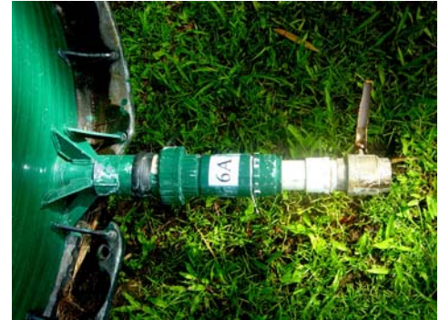
Imagen 2. Válvula de drenado 6A.
