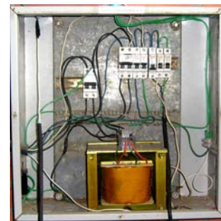
Imagen 17. Tablero de control N° 2
