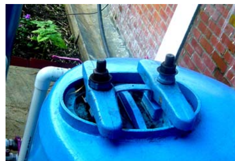
Imagen 2. Compuerta filtro de arena/carbón
