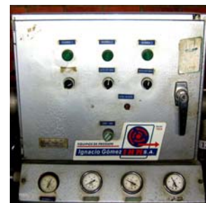
Imagen 19. Tablero de control N° 4
