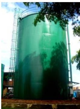
Imagen 1. Tanque de Sedimentación
