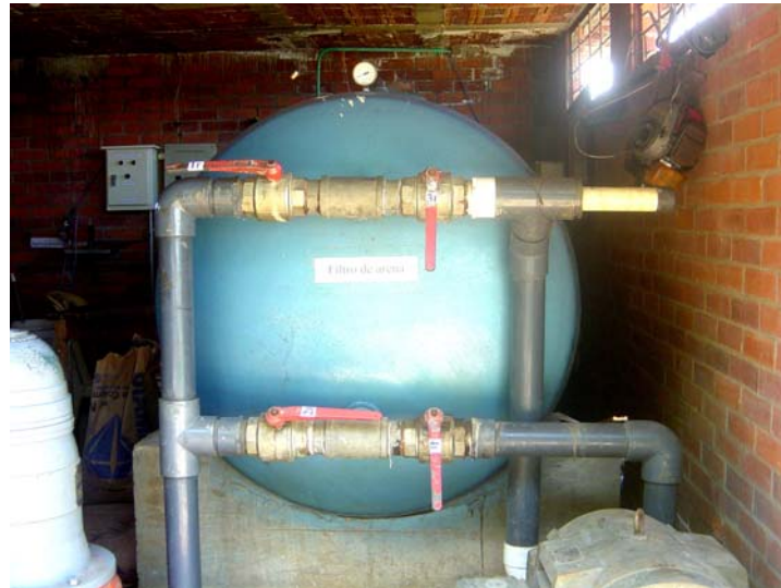
Imagen 1. Filtro de arena
