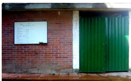
Imagen 8. Cuarto de bombeo
