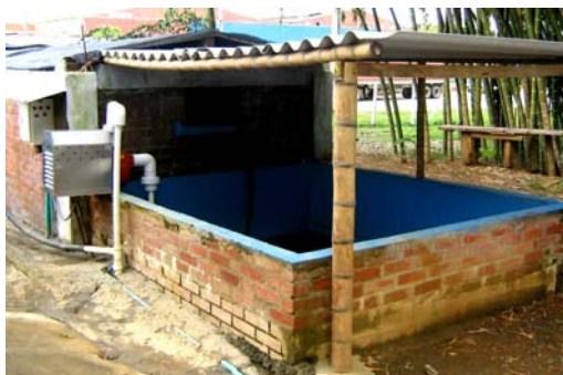
Imagen 7. Tanque recuperador de aguas
