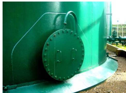
Imagen 1. Compuerta tanque de sedimentación
