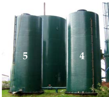
Imagen 5. Tanques Nº 4 y 5
