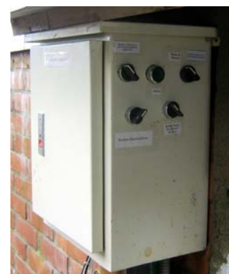
Imagen 18. Tablero de control N° 3
