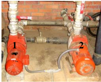
Imagen 9. Bombas de filtración
