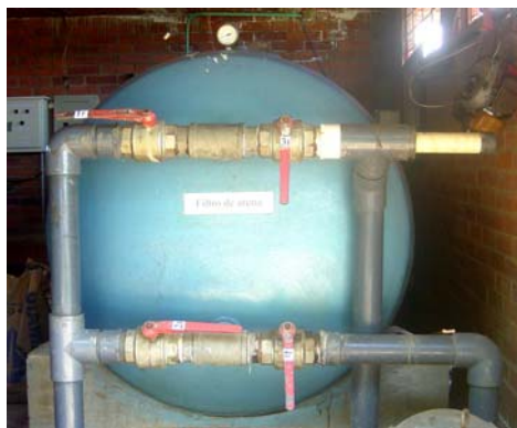
Imagen 13. Filtro de arena
