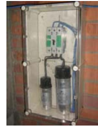
Imagen 20. Banco de condensadores
