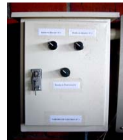
Imagen 16. Tablero de control N° 1
