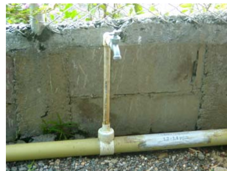
Imagen 2. Tomamuestras drenados tanques de almacenamiento
