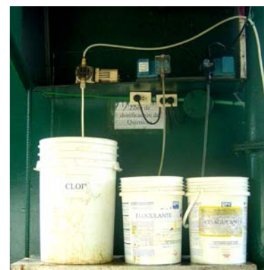
Imagen 3. Zona de dosificación de químicos
