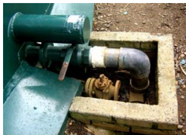
Imagen 2. Válvula de drenado 1C
