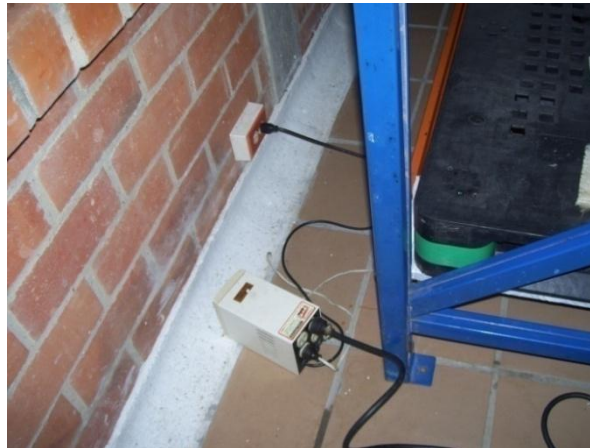
Figura 4 – 18 Foto 17: Conexión eléctrica cuarto de insumos Carnes frías
