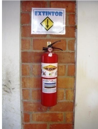
Figura 4 – 11 Foto 10: Extintor PQS
