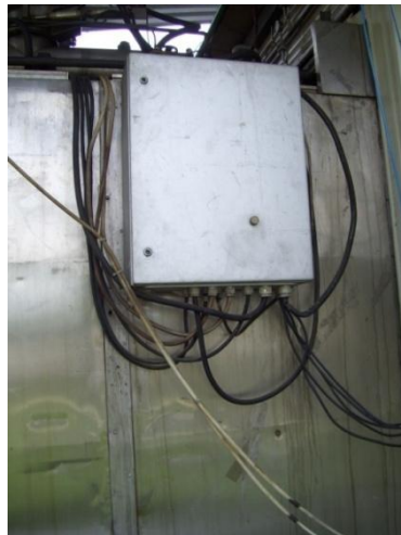
Figura 4–14 Foto 14: Sistema eléctrico de horno de ahumado
