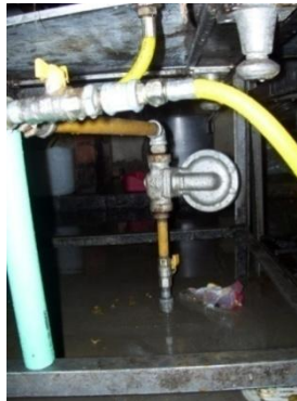
Figura 4 – 24 (Foto 23: Instalación de gas en cocina)
