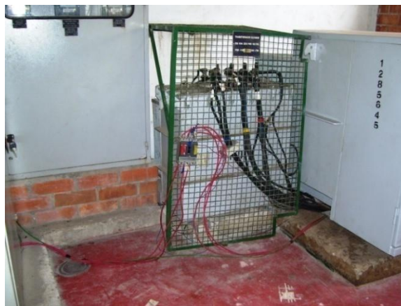
Figura 4 – 19 Foto 18: transformador 44° V subestación eléctrica 1
