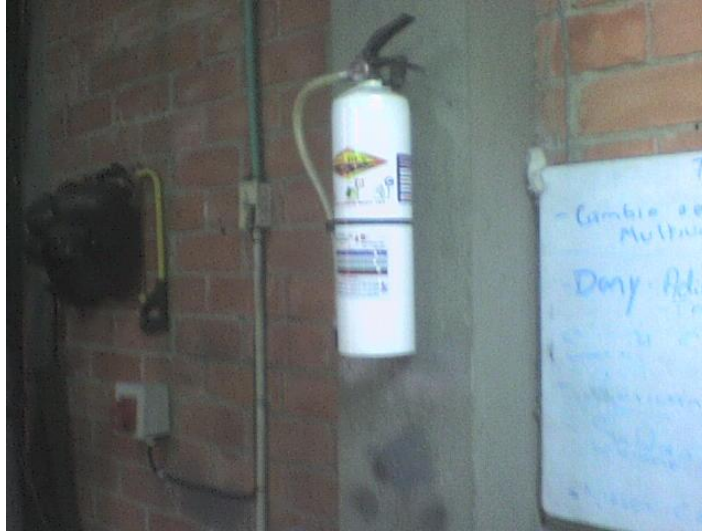
Figura 4–9 Foto 8: Extintor en Mantenimiento
