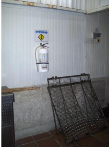
Figura 4–13 Foto 12: Extintor Hornos carnes frías.
