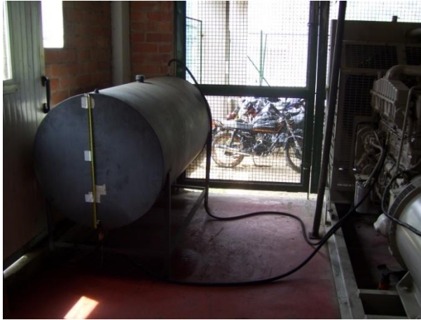
Figura 4 – 22 (Foto 21: Tanque de ACPM a la izquierda, planta de energía a la derecha)
