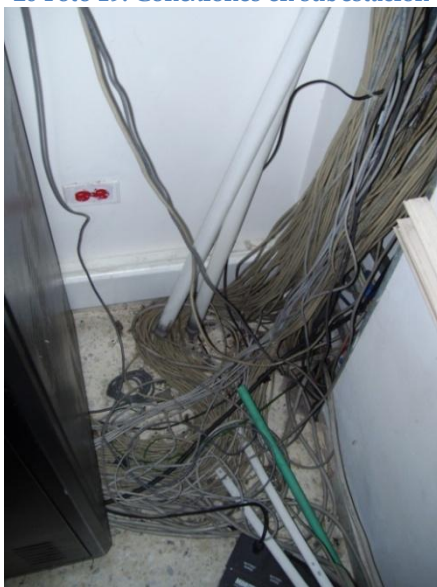
Figura 4 –21 Foto 20: Conexiones de comunicaciones cuarto de archivo
