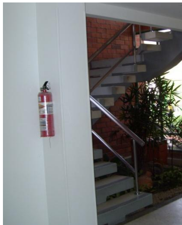
Figura 4–7 Foto 6: Extintor primer piso oficinas (al momento de tomar la foto se encontraba un extintor SOLKAFLAM)
