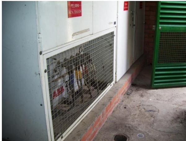
Figura 4–6 Foto 6: Señalización en cuarto de subestación eléctrica.
