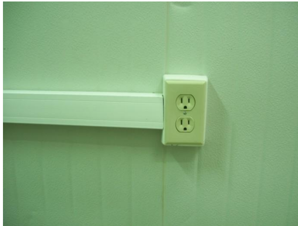
Figura 4 – 17 Foto 16: Toma eléctrico oficina de calidad carnes frías
