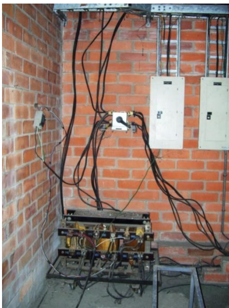
Figura 4 –20 Foto 19: Conexiones en subestación eléctrica 2
