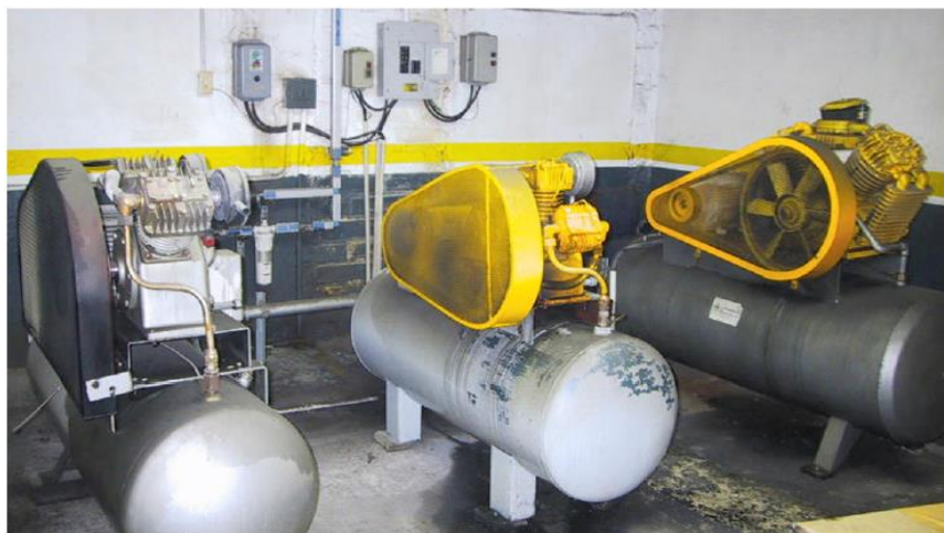
Figura 34. Cuarto de máquinas y control eléctrico
