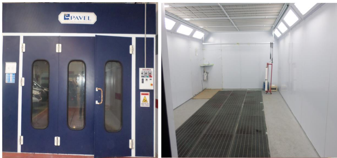
Figura 23. Cabina de pintura
