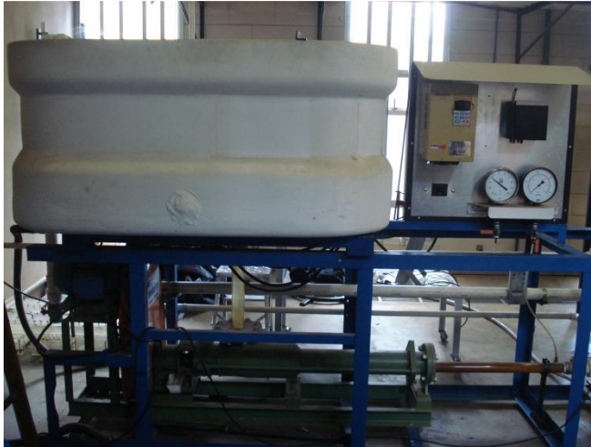
Figura 8. Tanque de Almacenamiento
