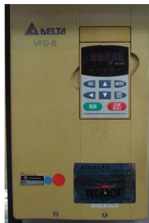
Figura 11. Variador de frecuencia
