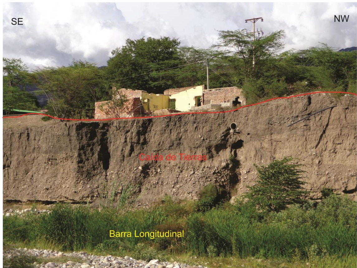
Figura 35. Caída de tierras vista detallada del escarpe y la ubicación sobre el Río Chicamocha en depósitos aluviales del cuaternario, Capitanejo.
