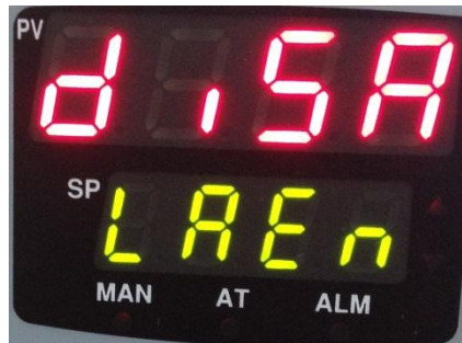
Figura 124. Foto de la pantalla del UDC 1200 en el parámetro alarma de lazo.
