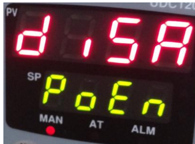
Figura 148. Foto de la pantalla del UDC 1200 en el parámetro selección del control automatico/manual
