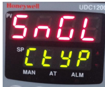
Figura 119. Foto de la pantalla del UDC 1200 en el parámetro tipo de control
