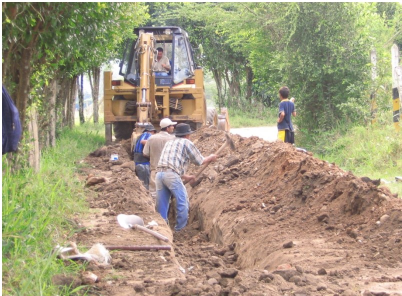
Figura 7. Sistema de Abastecimiento Provisional no convencional de agua potable para el asentamiento humano Nueva Colombia
