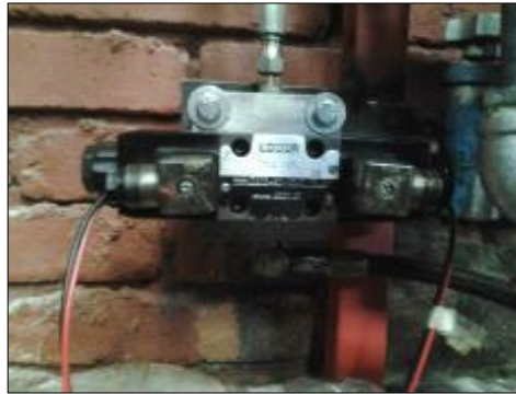
Figura 8. Electroválvula del circuito de carga resistiva
