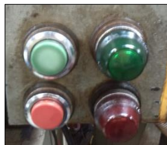
Figura 103. Botones de encendido (verde) y apagado (rojo) de la bomba principal de caudal variable
