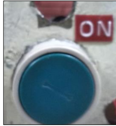
Figura 99. Botón de encendido bomba circuito hidráulico del actuador
