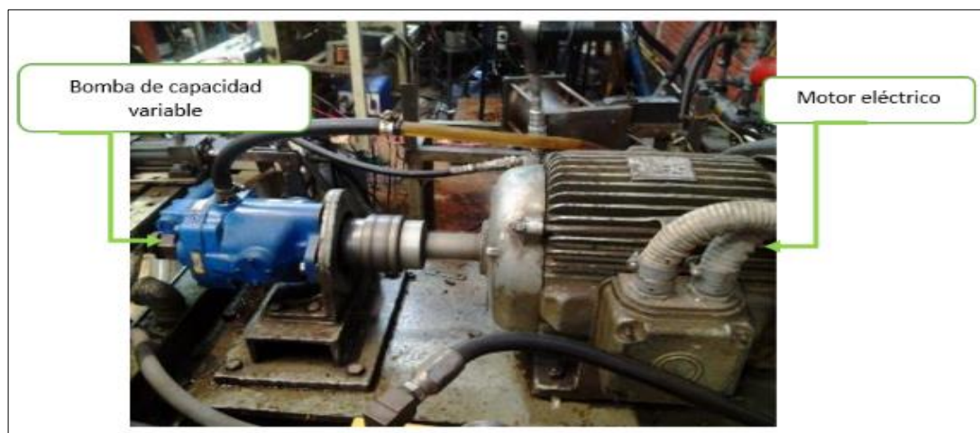
Figura 12. Montaje de la bomba variable y el motor eléctrico
