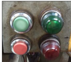
Figura 118. Botones de encendido (verde) y apagado(rojo) de la bomba principal de caudal variable
