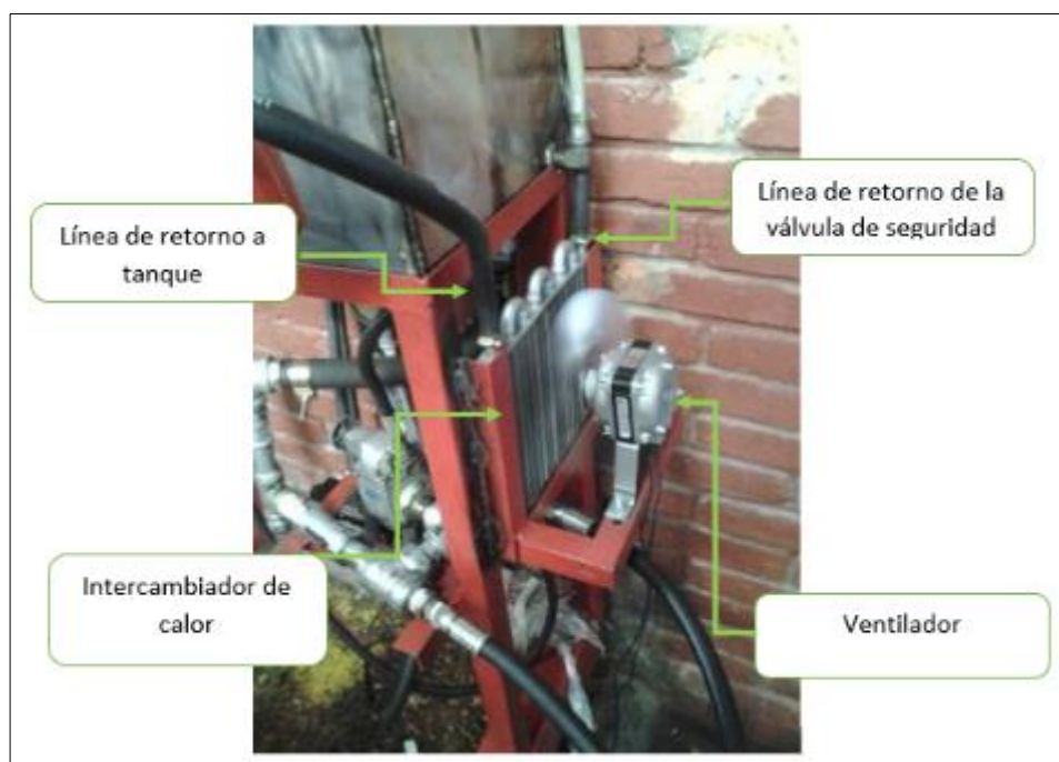
Figura 24. Sistema de refrigeración del circuito de cargas resistivas
