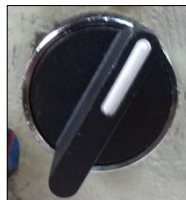
Figura 101. Interruptor de encendido y apagado de la bomba centrífuga de la torre de enfriamiento
