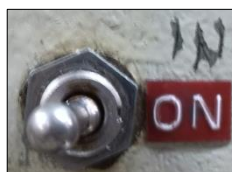
Figura 119. Interruptor de encendido y apagado de la bomba de precarga
