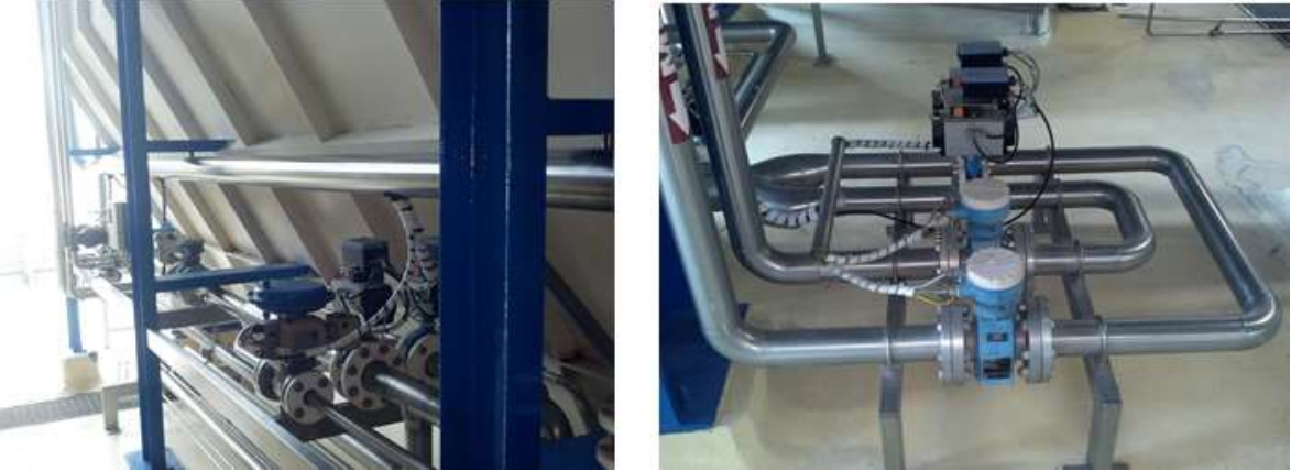
Figura 64. Válvulas de dosificación de agua y de salida del mosto, después de la limpieza inicial
