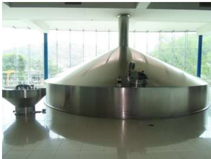
Figura 28. Parte superior olla de filtración
