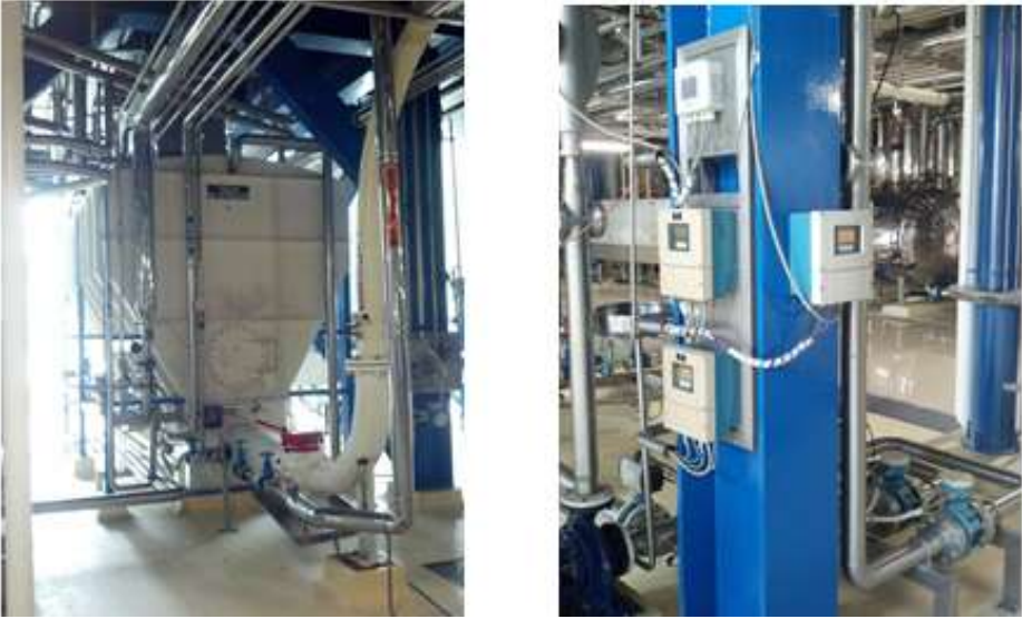
Figura 63. Tolva vista frontal y tablero de control manual, después de la limpieza inicial
