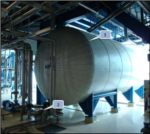
Figura 36. Tanque auxiliar de mosto y juego de válvulas
