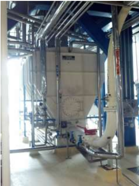
Figura 37. Tolva de afrecho y línea de salida de afrecho hacia secador
