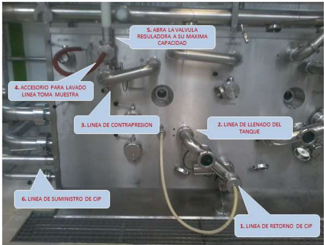
Figura 49. Espejo de distribución de los tanques para inicio del CIP
