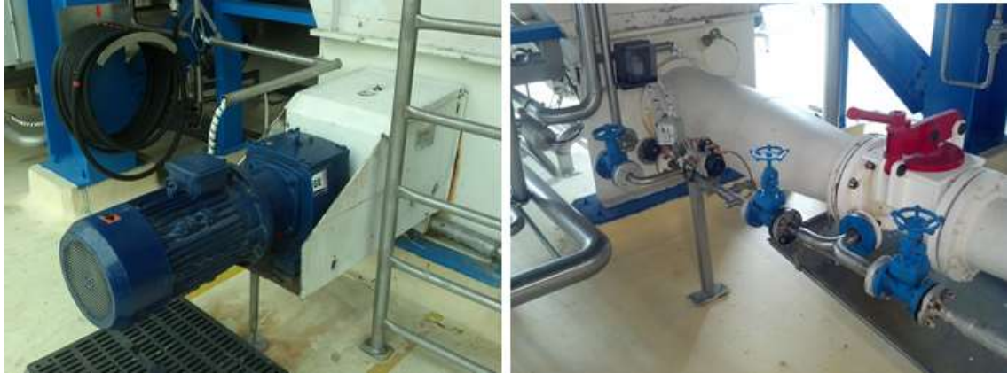
Figura 65. Moto-reductor del sinfín y válvulas de vapor y aire comprimido, después de la limpieza inicial
