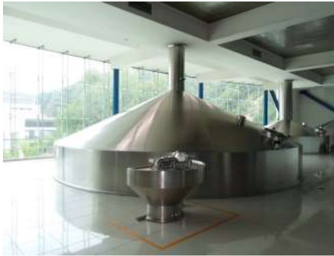
Figura 5. Cuba de filtración ZIEMANN cervecería Bucaramanga
