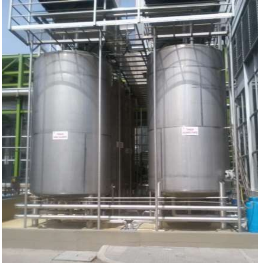
Figura 47. Tanques sistema CIP
