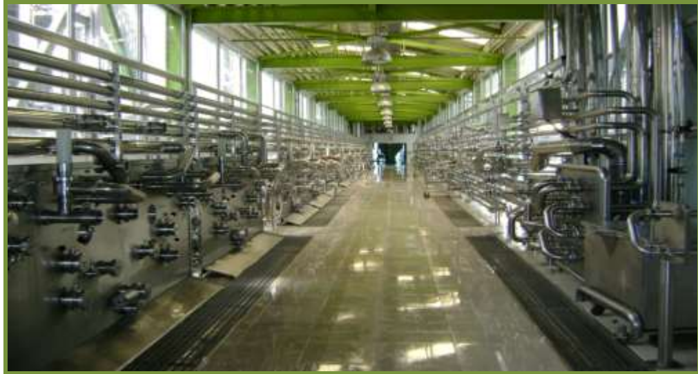
Figura 44. Pasillo de servicios Unitanques
