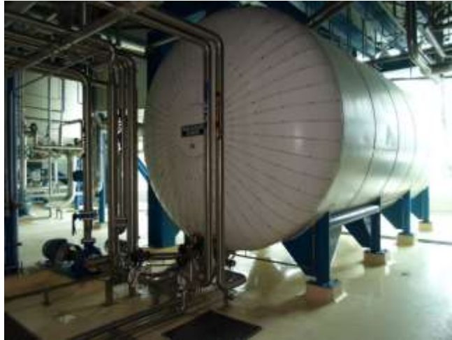
Figura 13. Tanque auxiliar de mosto
