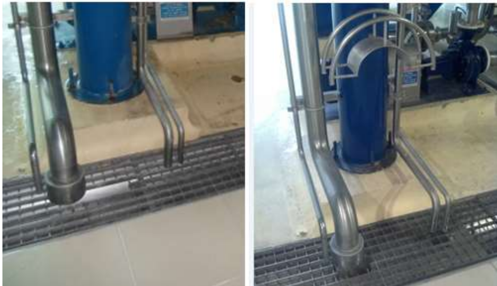
Figura 67.Desagüe de proceso. Antes y después
