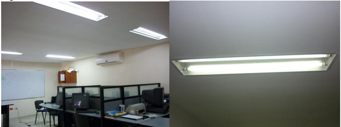
Figura 95. Sistema de Iluminación
