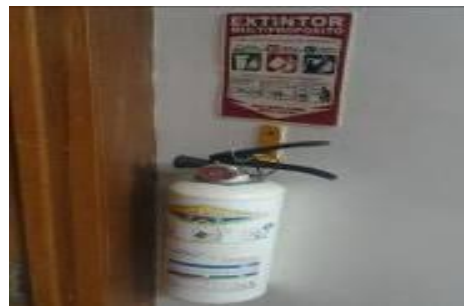
Imagen 9. Único extintor de la sede administrativa
