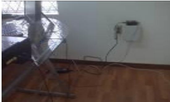
Imagen 10. Cableado de los equipos de almacén
