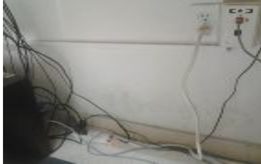
Imagen 12. Cableado de los equipos de HSE
