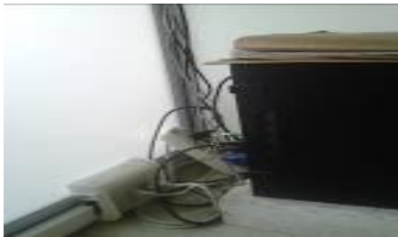
Imagen 11. Cableado de los equipos de recepción
