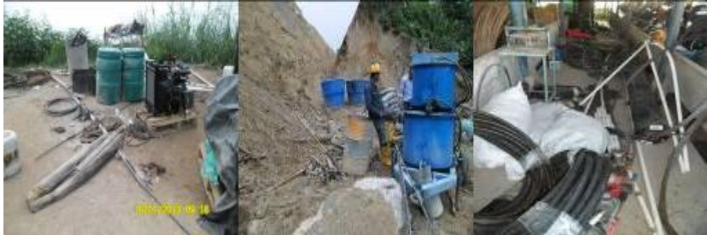
Imagen 18. Falta de orden y aseo en el proyecto
